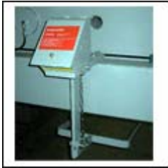
起升冲顶限位开关
