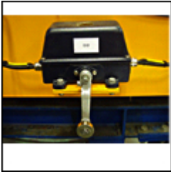
大车运行限位开关
