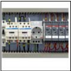
电控柜接线端子
